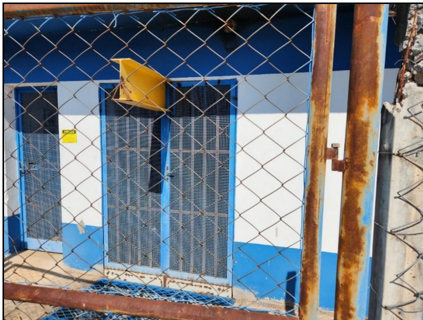
Figura 62 - Booster Zona Sul
