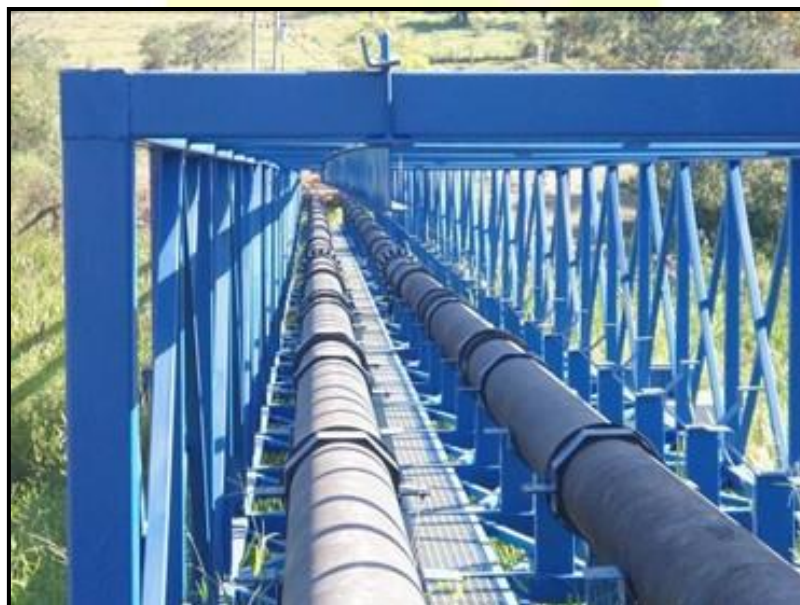
Figura 19 - Travessia das adutoras
