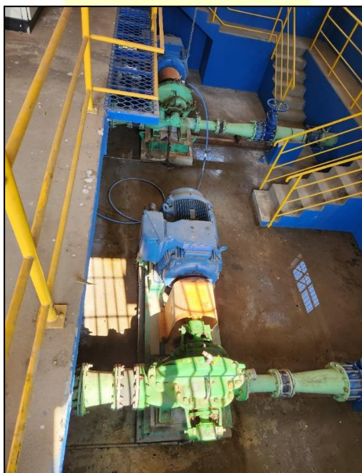
Figura 63 - Conjuntos Motor-Bomba do Zona Sul
