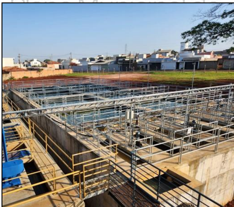
Figura 27 - Floculadores e decantadores da ampliação da estação
