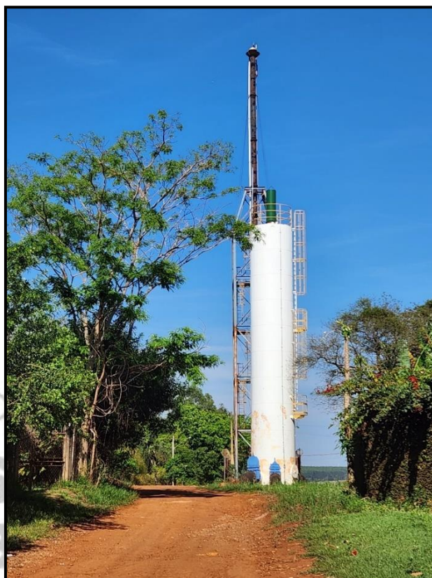
Figura 16 - Chaminé de equilíbrio de pressão - Stand Pipe
