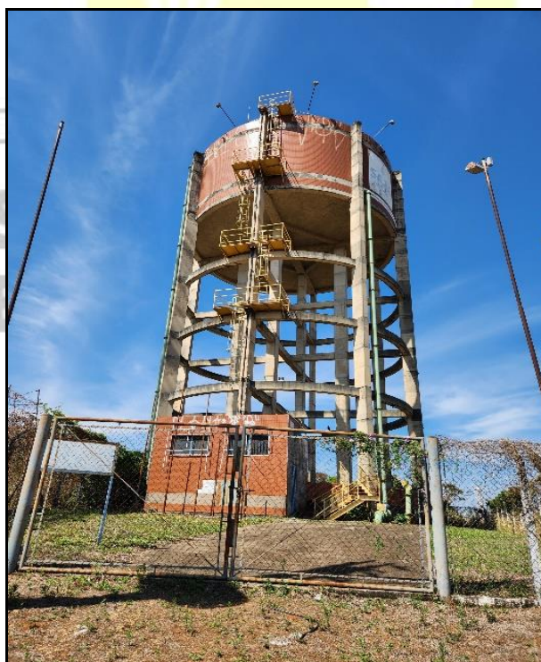
Figura 48 - Reservatório Jardim Paulista
