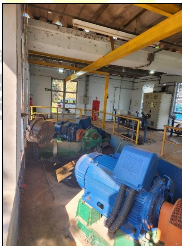
Figura 13 - Conjuntos Motor-Bomba 1 e 2
