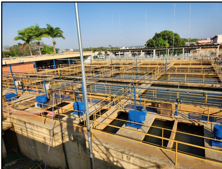
Figura 26 - Floculadores e decantadores da estação antiga
