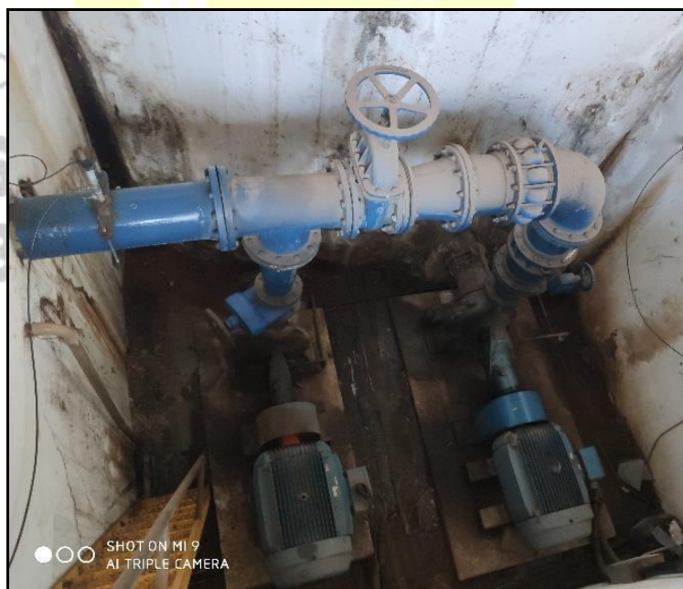
Figura 41 - Barrilete e bombas da estação elevatória da Sede
