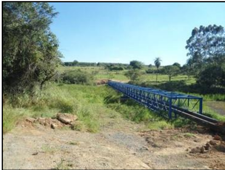
Figura 18 - Travessia das adutoras
