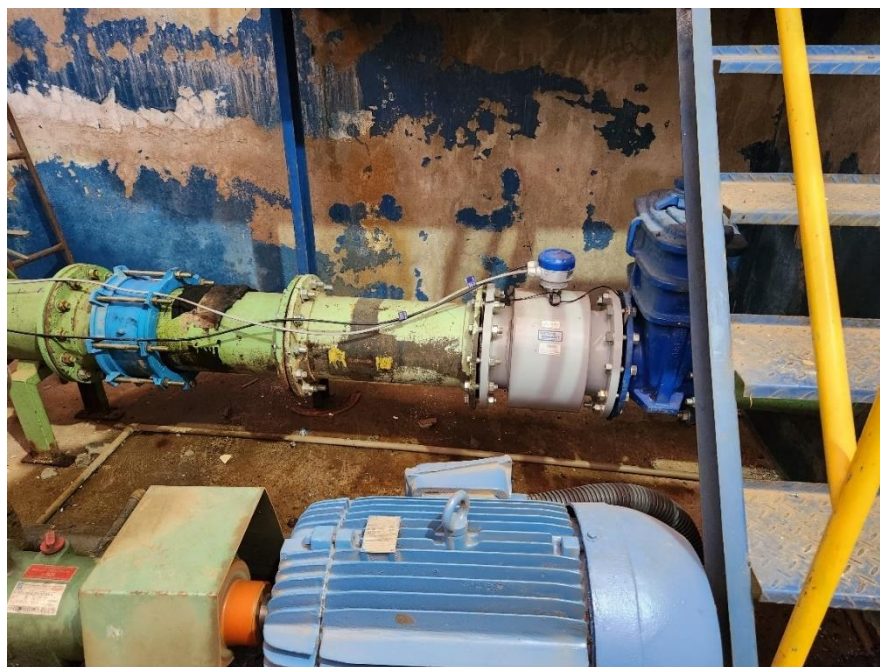
Figura 49 - Barrilete e conjuntos motor bomba
