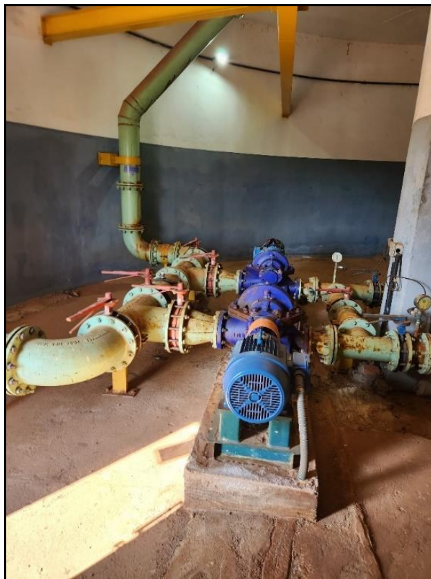
Figura 43 - Barrilete e conjuntos motor bomba
