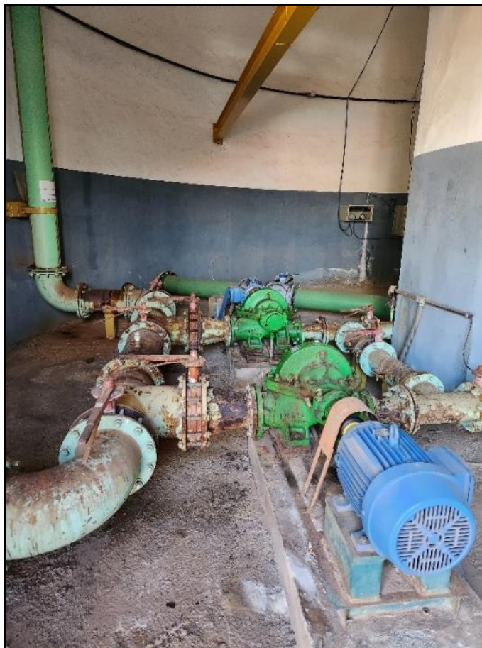
Figura 45 - Barrilete e conjuntos motor bomba
