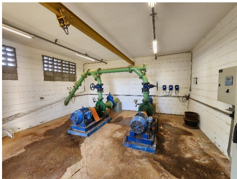
Figura 50 - Barrilete e conjuntos motor bomba
