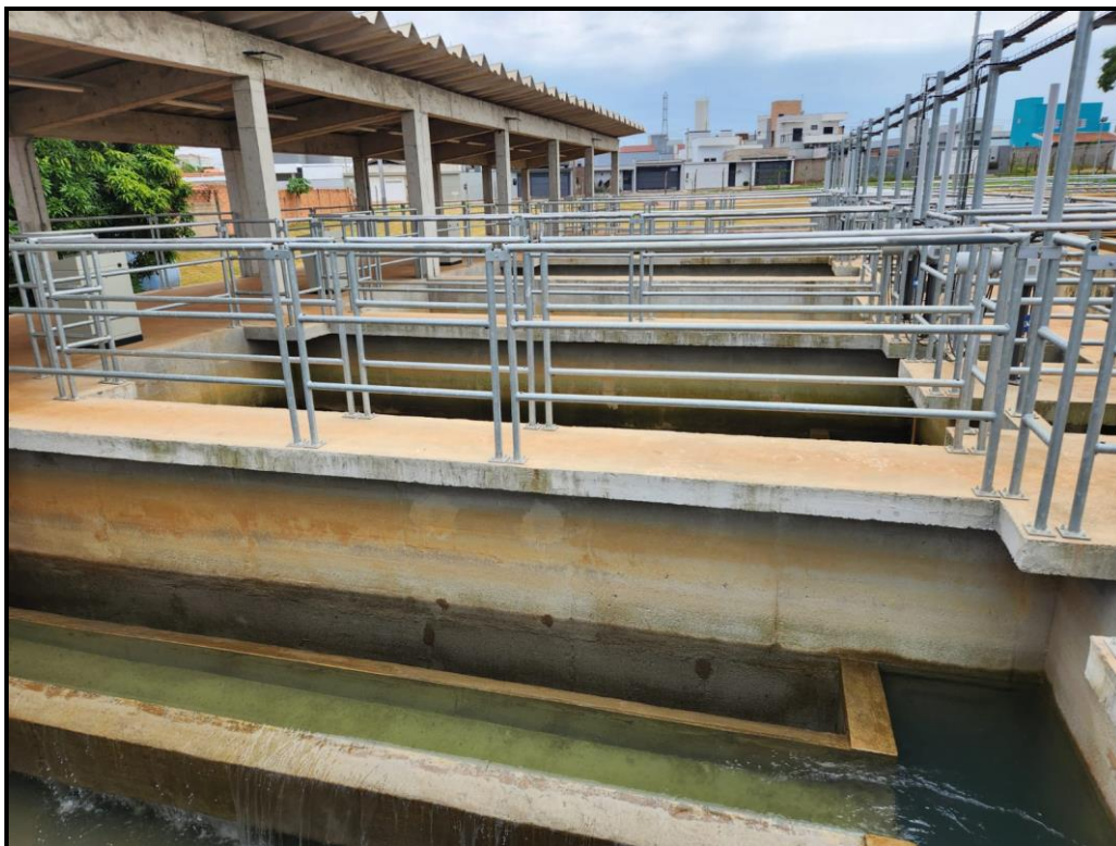
Figura 29 - Filtros da ampliação da estação
