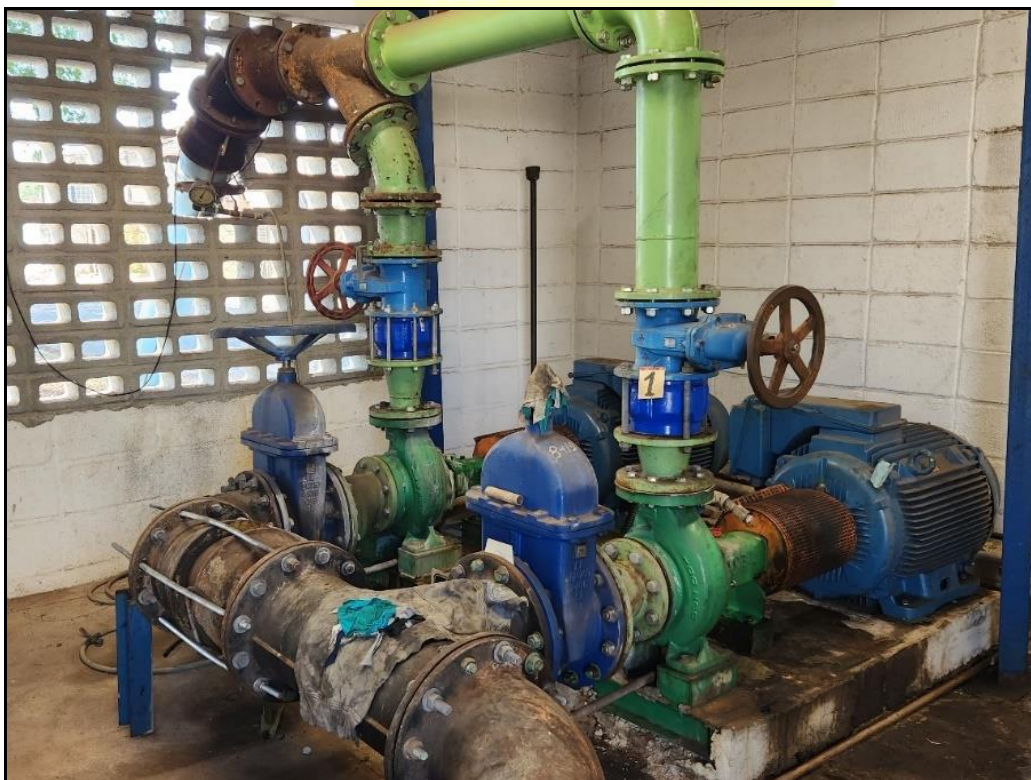
Figura 61 - Conjuntos Motor-Bomba do Booster TG
