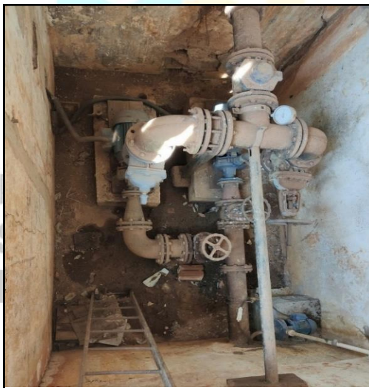
Figura 38 - Vista das instalações do Booster ETA I
