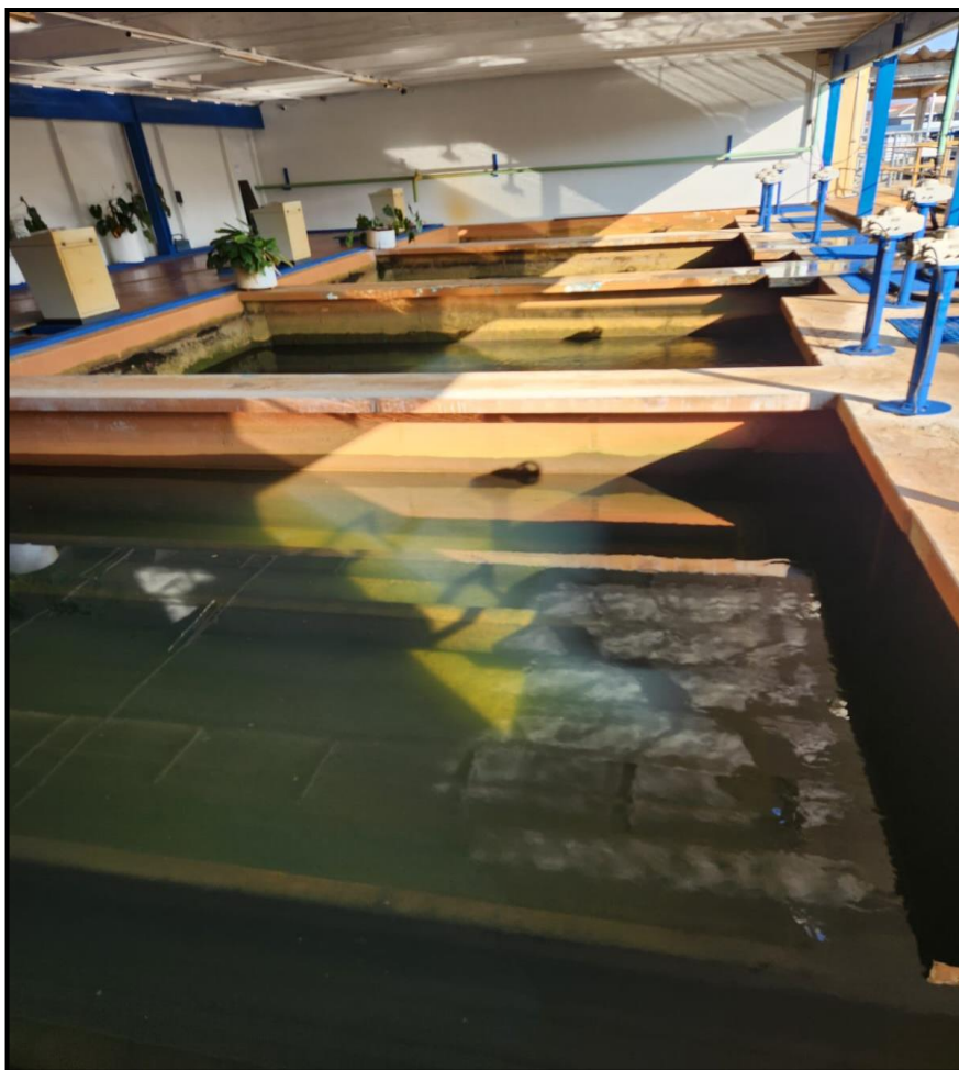
Figura 28 - Filtros da estação antiga
