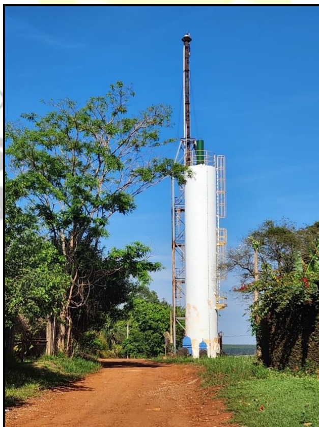
Figura 7 - Chaminé de equilíbrio de pressão - Stand Pipe
