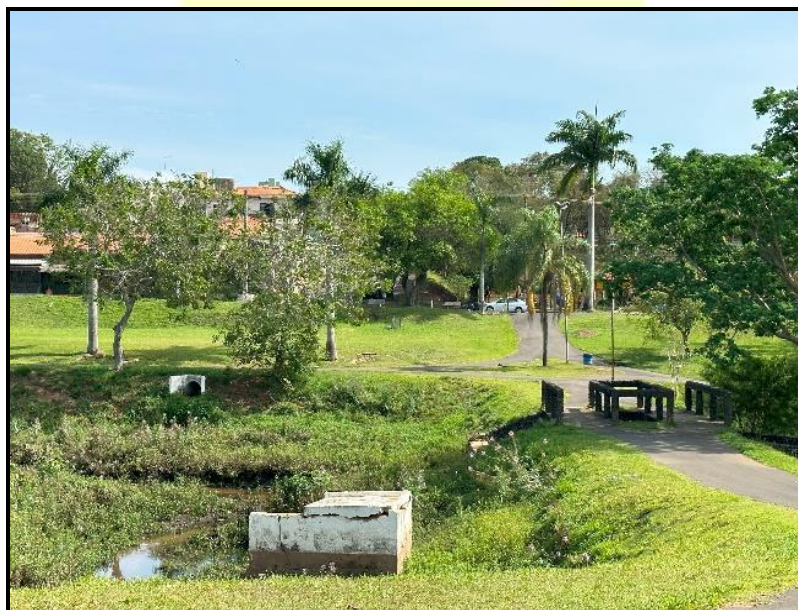
Figura 136 - Assoreamento no barramento do Córrego Lavapés
