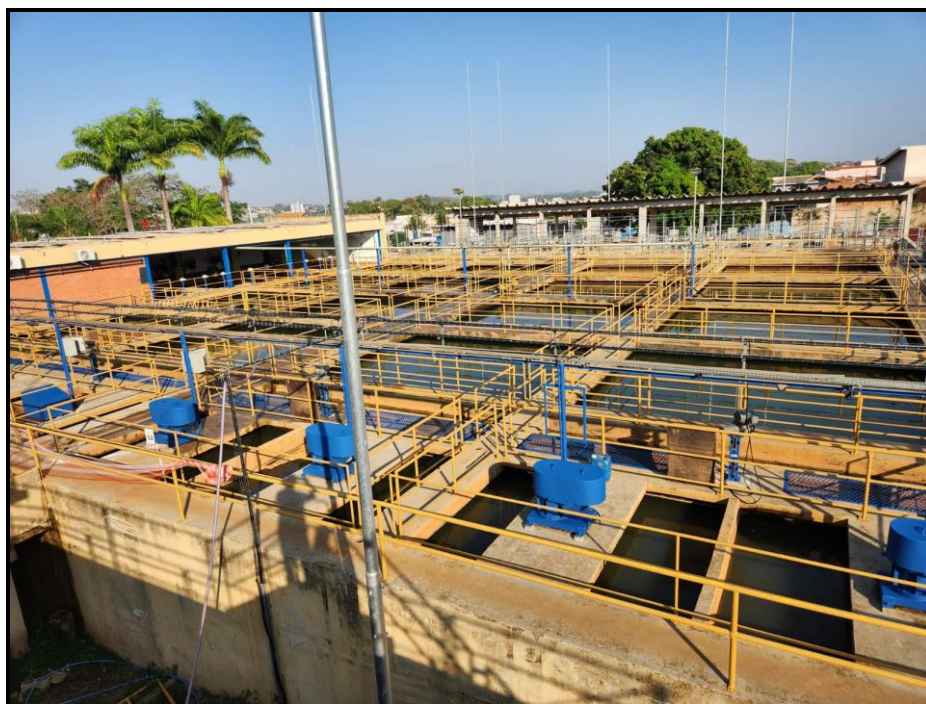
Figura 33 - Floculadores e decantadores da estação antiga
