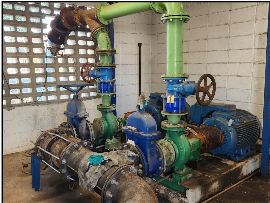
Figura 90 - Conjuntos Motor-Bomba do Booster TG
