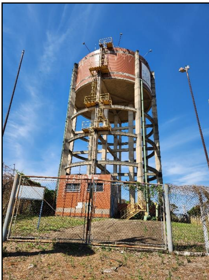
Figura 66 - Reservatório Jardim Paulista
