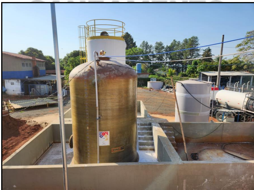
Figura 39 - Sistema armazenamento de produtos químicos
