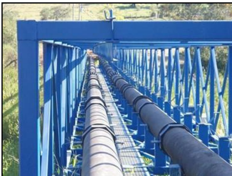
Figura 26 - Travessia das adutoras
