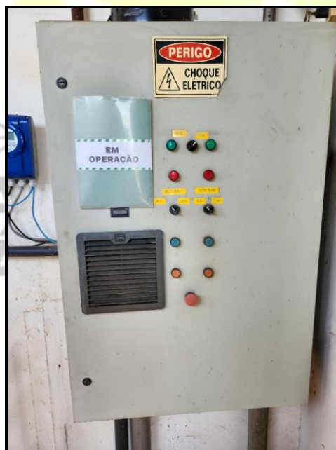
Figura 68 - Painel elétrico da estação elevatória
