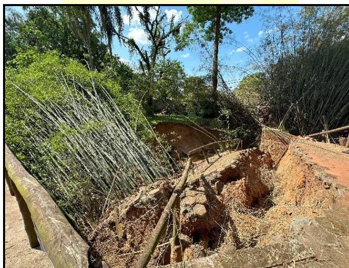
Figura 138 - Rompimento no vertedor do Córrego Bela Vista
