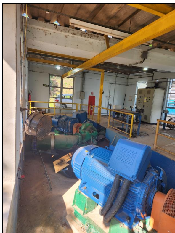
Figura 20 - Conjuntos Motor-Bomba 1 e 2
