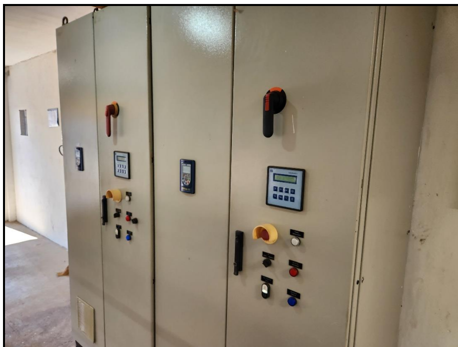
Figura 94 - Painel elétrico do Zona Sul
