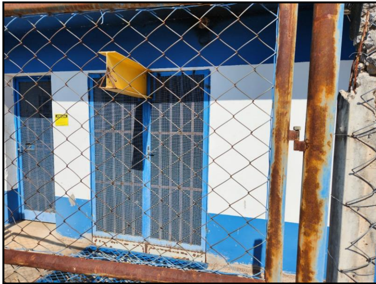
Figura 92 - Booster Zona Sul
