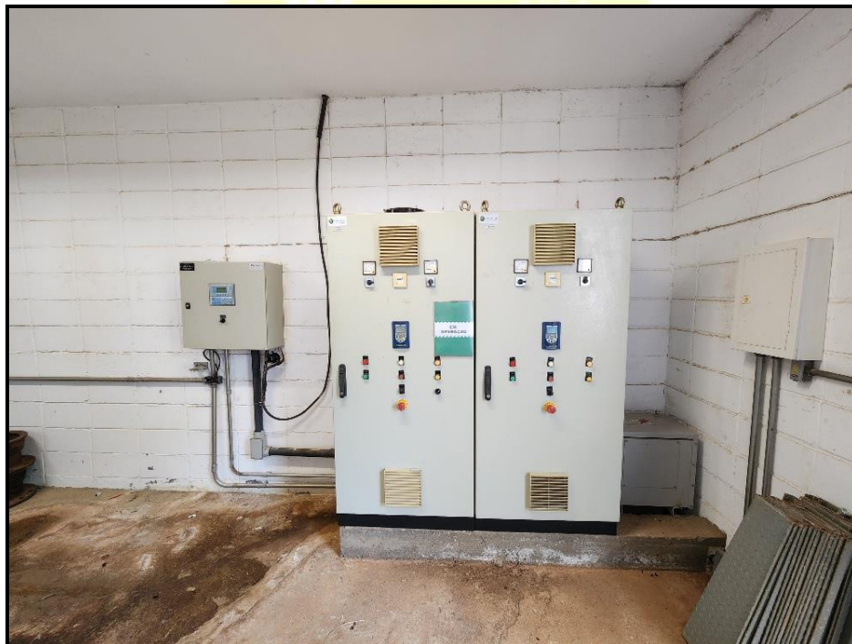
Figura 72 - Painel elétrico da estação elevatória
