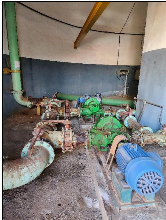
Figura 59 - Barrilete e conjuntos motor bomba
