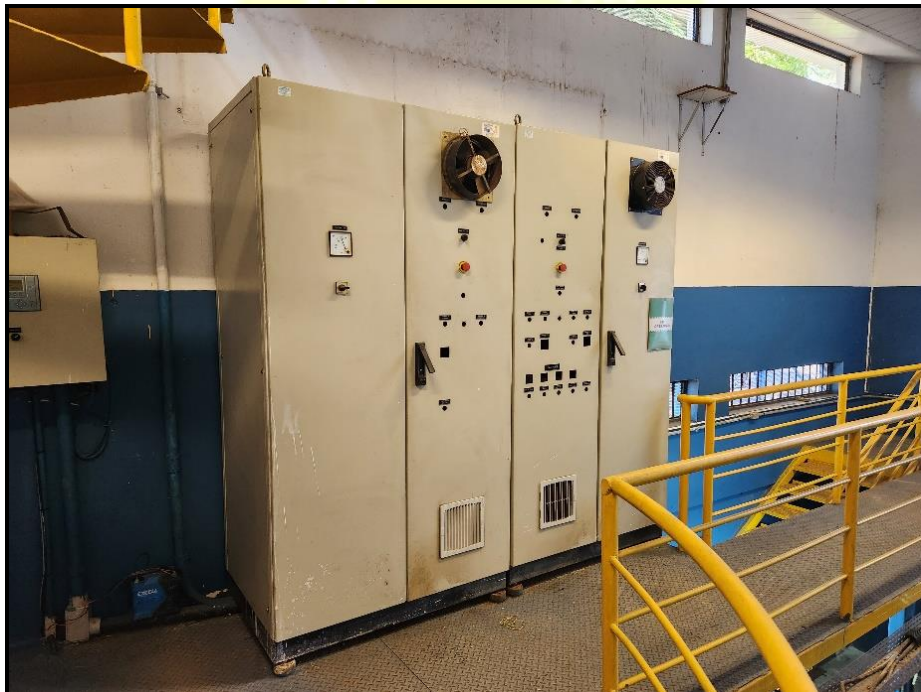
Figura 64 - Painel elétrico da estação elevatória
