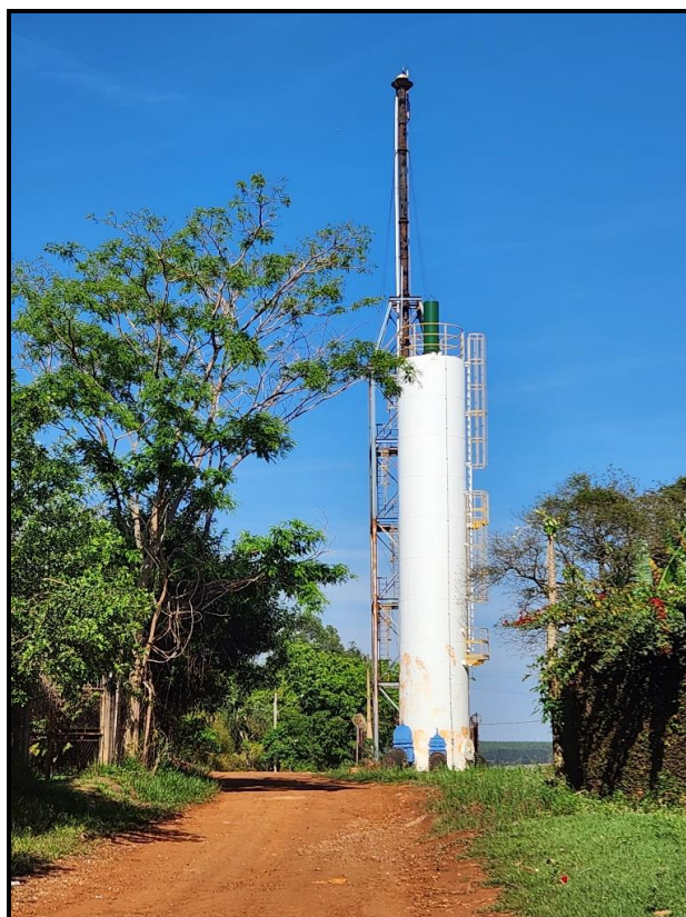
Figura 23 - Chaminé de equilíbrio de pressão - Stand Pipe
