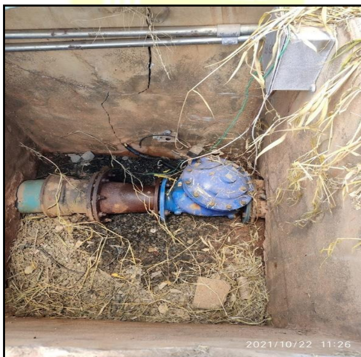
Figura 81 - Válvula de controle de nível
