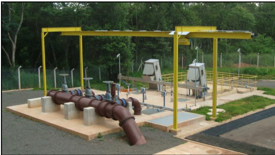
Figura 99 - Estação elevatória de esgotos da ETE
