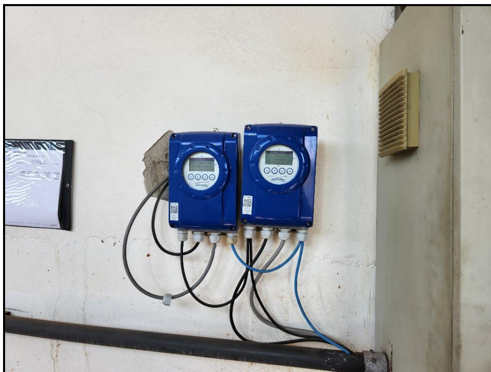
Figura 69 - Painel de telemetria da estação elevatória
