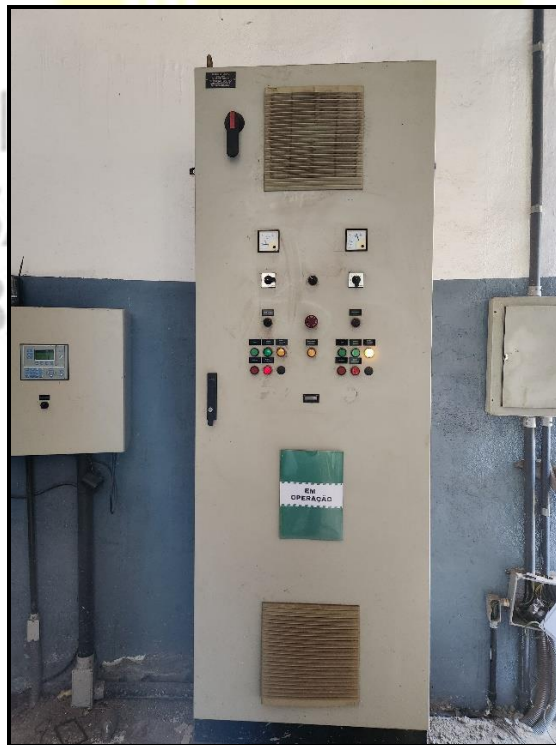
Figura 60 - Painel elétrico da estação elevatória
