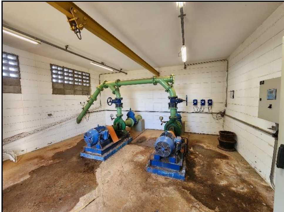
Figura 71 - Barrilete e conjuntos motor bomba
