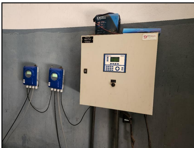
Figura 57 - Painel de telemetria da estação elevatória
