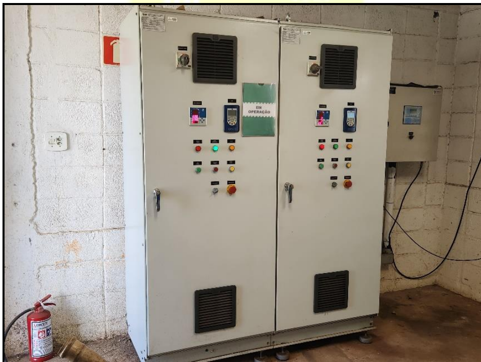
Figura 91 - Pannel elétrico do Booster TG
