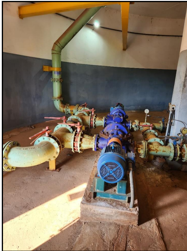
Figura 55 - Barrilete e conjuntos motor bomba
