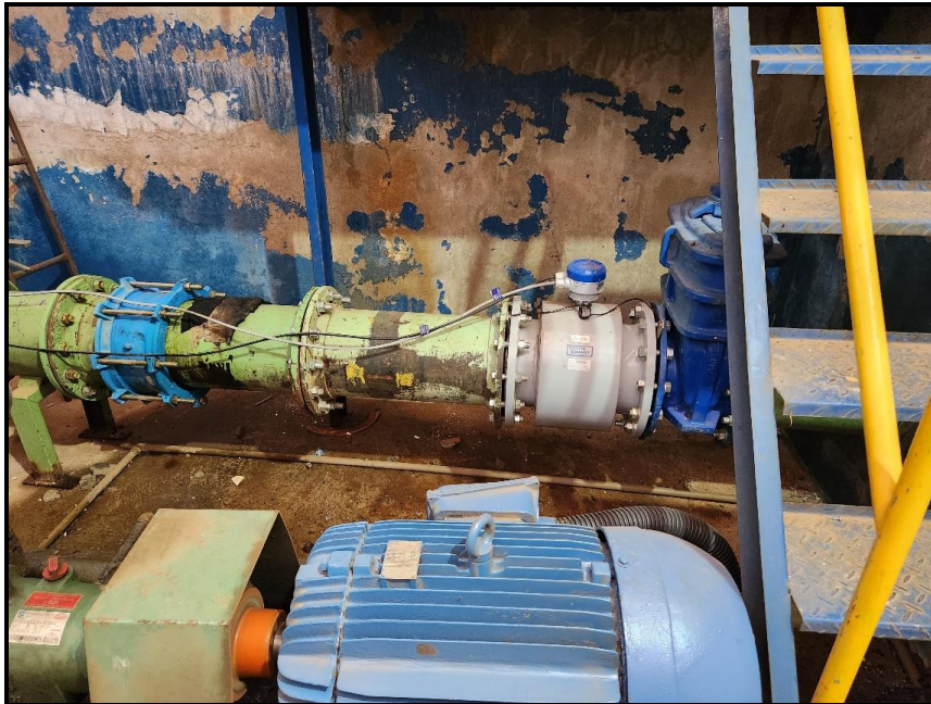
Figura 67 - Barrilete e conjuntos motor bomba
