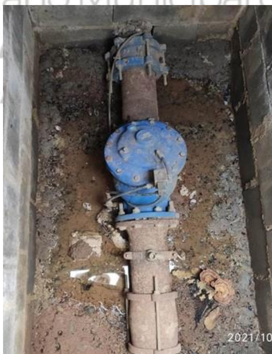
Figura 83 - Válvula de controle de nível
