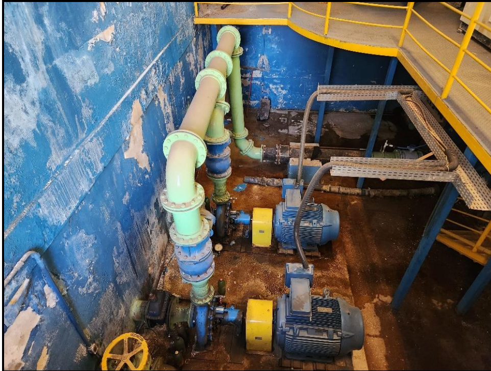
Figura 63 - Barrilete e conjuntos motor bomba
