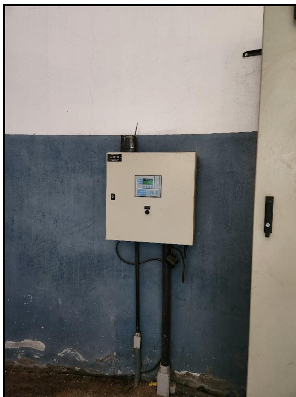
Figura 61 - Painel de telemetria da estação elevatória
