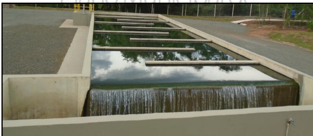
Figura 103 - Câmara de cloração
