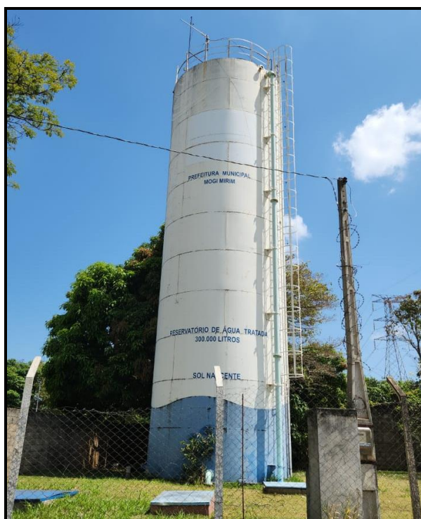
Figura 80 - Reservatório Chácaras Sol Nascente
