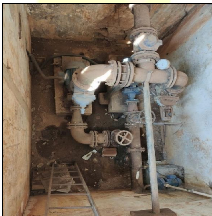
Figura 49 - Vista das instalações do Booster ETA I
